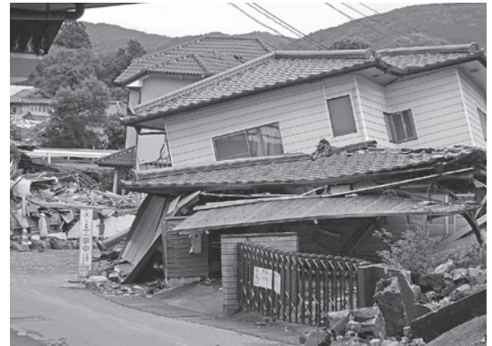
熊本地震被害状況
